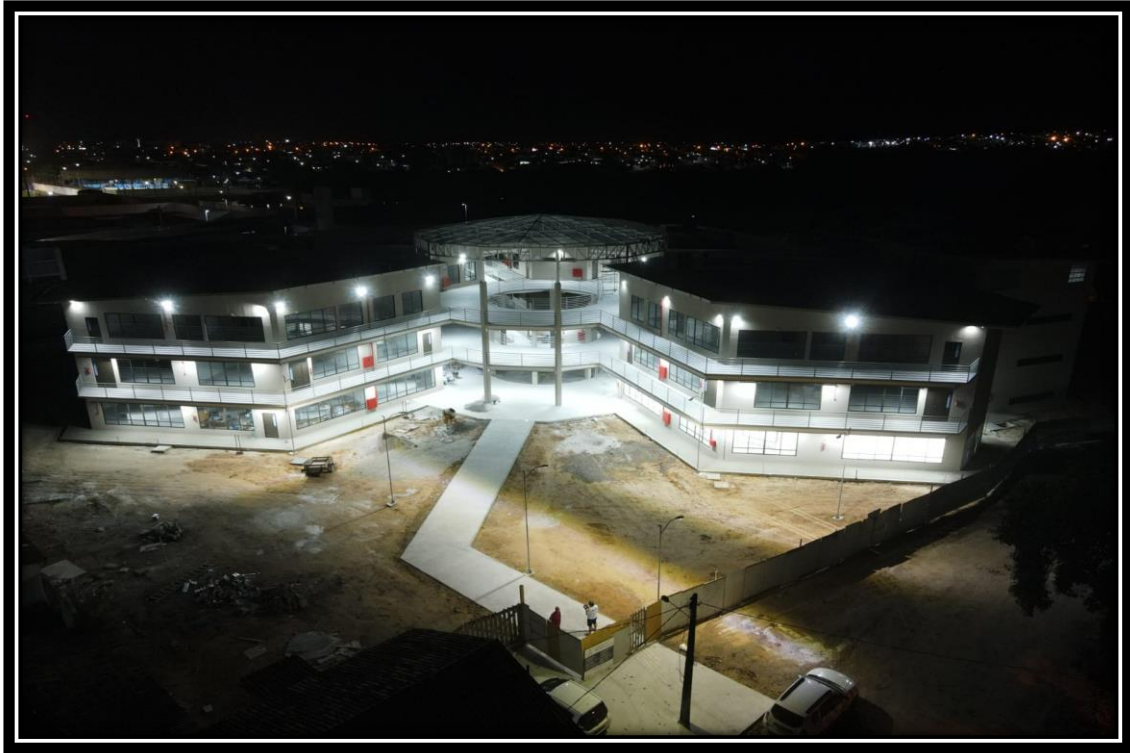
Figura 3- Imagem aérea da Obra de Construção do prédio do Núcleo Pedagógico do Campus Paulo Freire na área do Complexo 2
